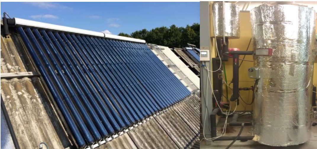
Figur 3. Solfangere, tømme-tank og varmelager for solvarmeanlægget der blev afprøvet i DTU's prøvestand for solvarmeanlæg.
