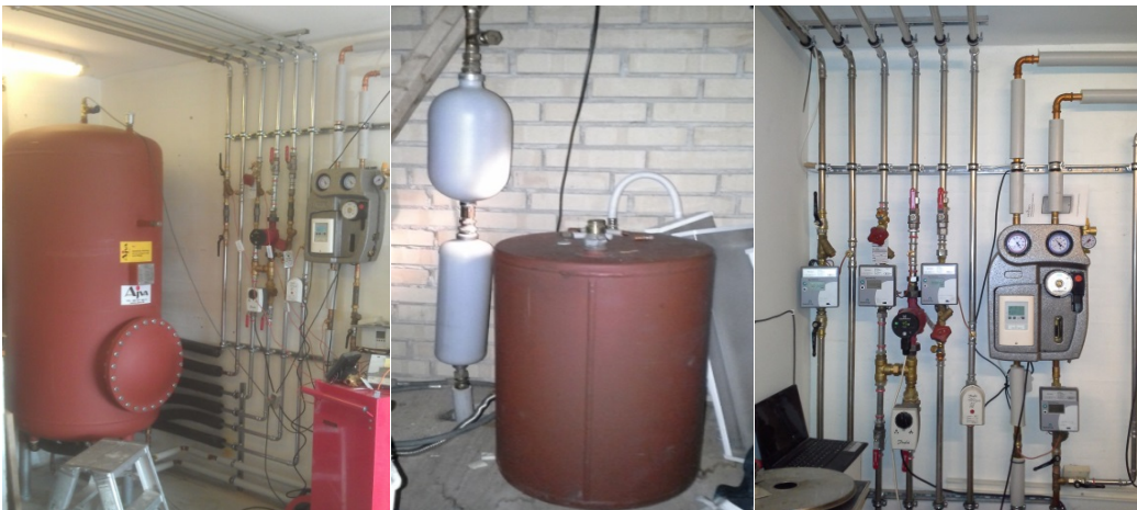
Figur 5. Varmelager, tømmetankarrangement og rør til og fra varmelageret inklusive energimålere for demonstrationsanlægget i Sorø.
