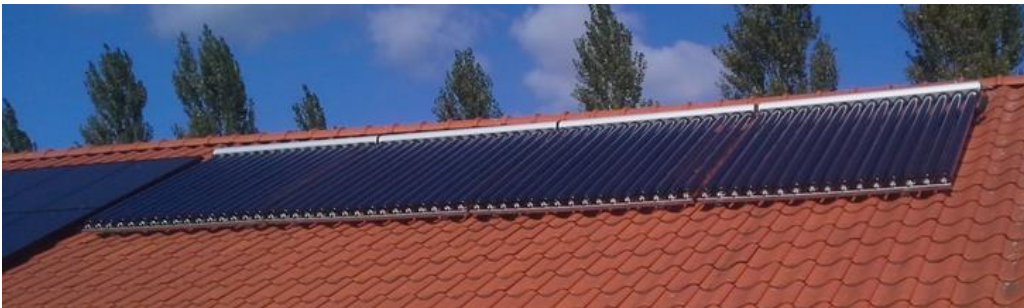
Figur 4. Solfangere for demonstrationsanlægget i Sorø.
